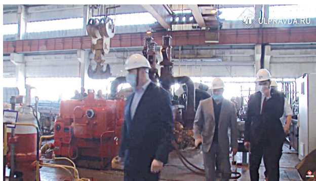
■ Глава региона Алексей Русских посетил ТЭЦ-1 и дал ряд поручений по подготовке объектов теплоисточников.
